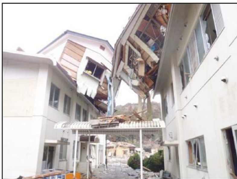
センター2棟の屋根部に流出民家が乗り上げている様子 (3月15日午前9時54分)。 鈴木善幸 撮影
